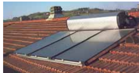
Impianto solare termico
